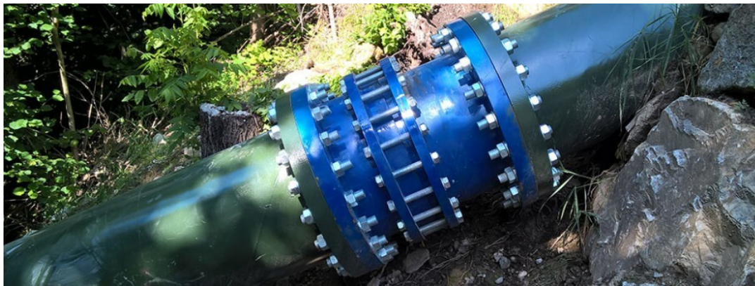
Figura 1: Giunto di dilatazione (colore blu) lungo condotta forzata in acciaio
