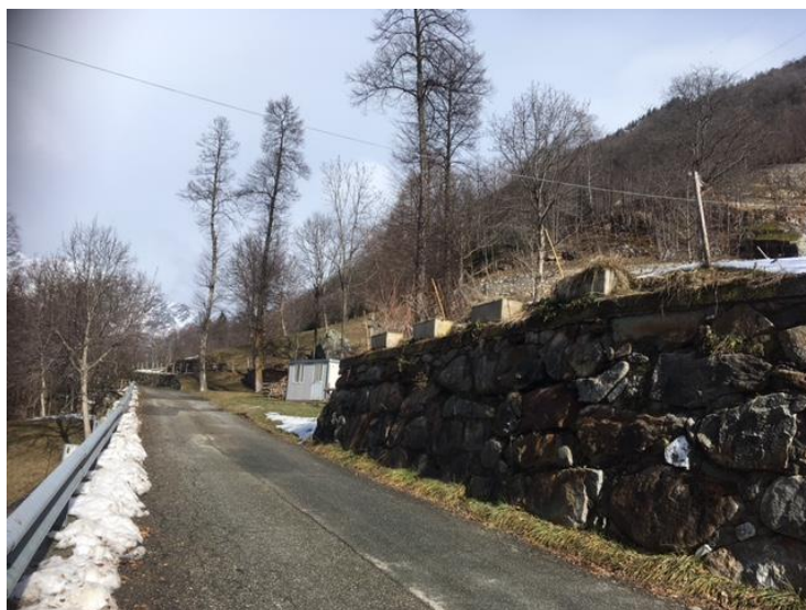
Fig. 14: Il tratto dove termina il cavidotto MT interrato, sulla destra orografica del torrente.
