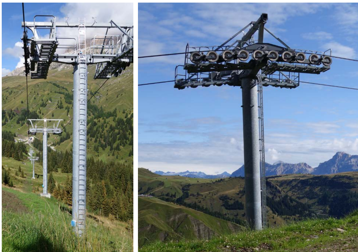
Figura 15. Esempio di sostegni realizzati su una seggiovia esaposto marca Leitner.
