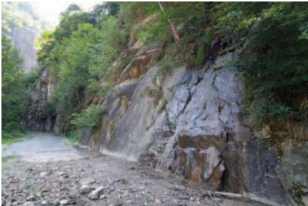
Foto 2: vista da valle della diramazione della sr n° 44 presso Rechentier. In primo piano i detriti portati da piccole frane e colamenti, sullo sfondo una parete rocciosa aggettante.
