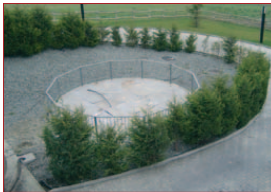
(figure 7) Bassin de stockage des eaux résiduelles
