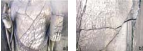
2. a) Esempio di fessure dovute all'azione congiunta dell'acqua e della disomogeneità dei materiali, b) esempio di erosione superficiale con frattura in fase di completo distacco. (D. Vaudan)
