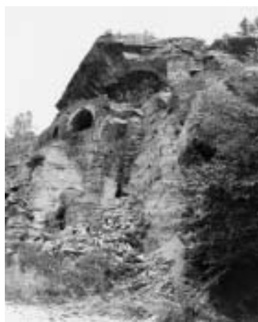
1. Tratto di strada romana crollata nel 1985, sopra l'attuale galleria di Runaz. (Studio Di Grazia)
