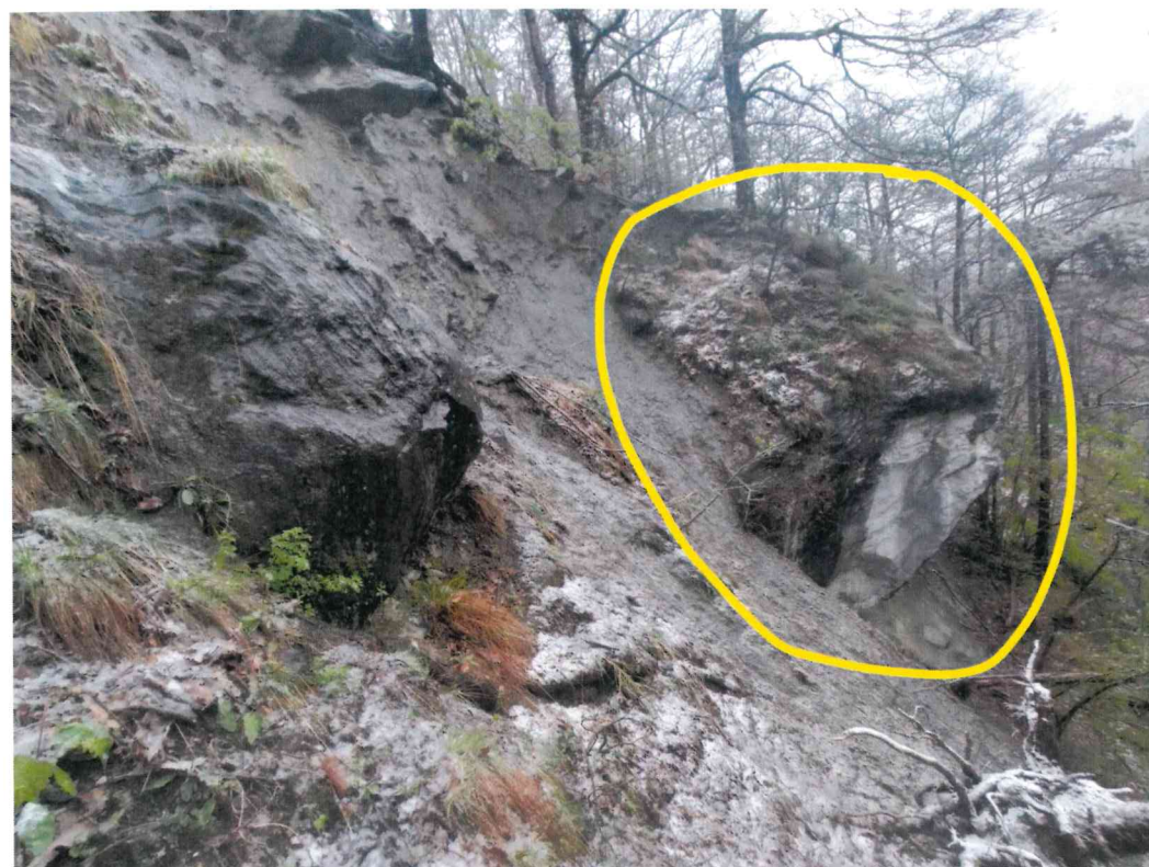
FOTO 3: vista laterale del masso di dimensioni di circa 80 mc da stabilizzare
