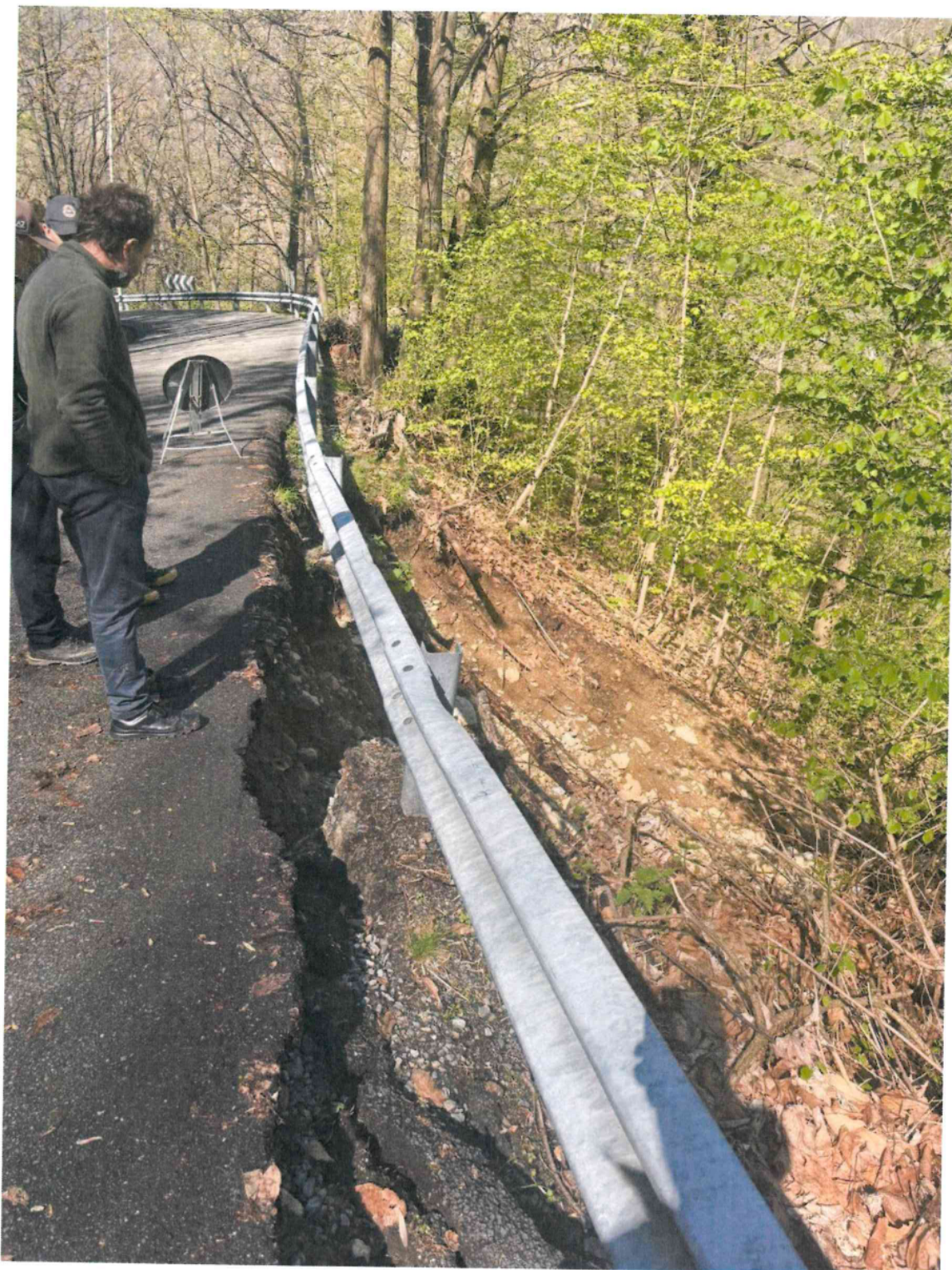
FOTO 1 : vista del primo cedimento strutturale stradale nei pressi della Loc. Suc
