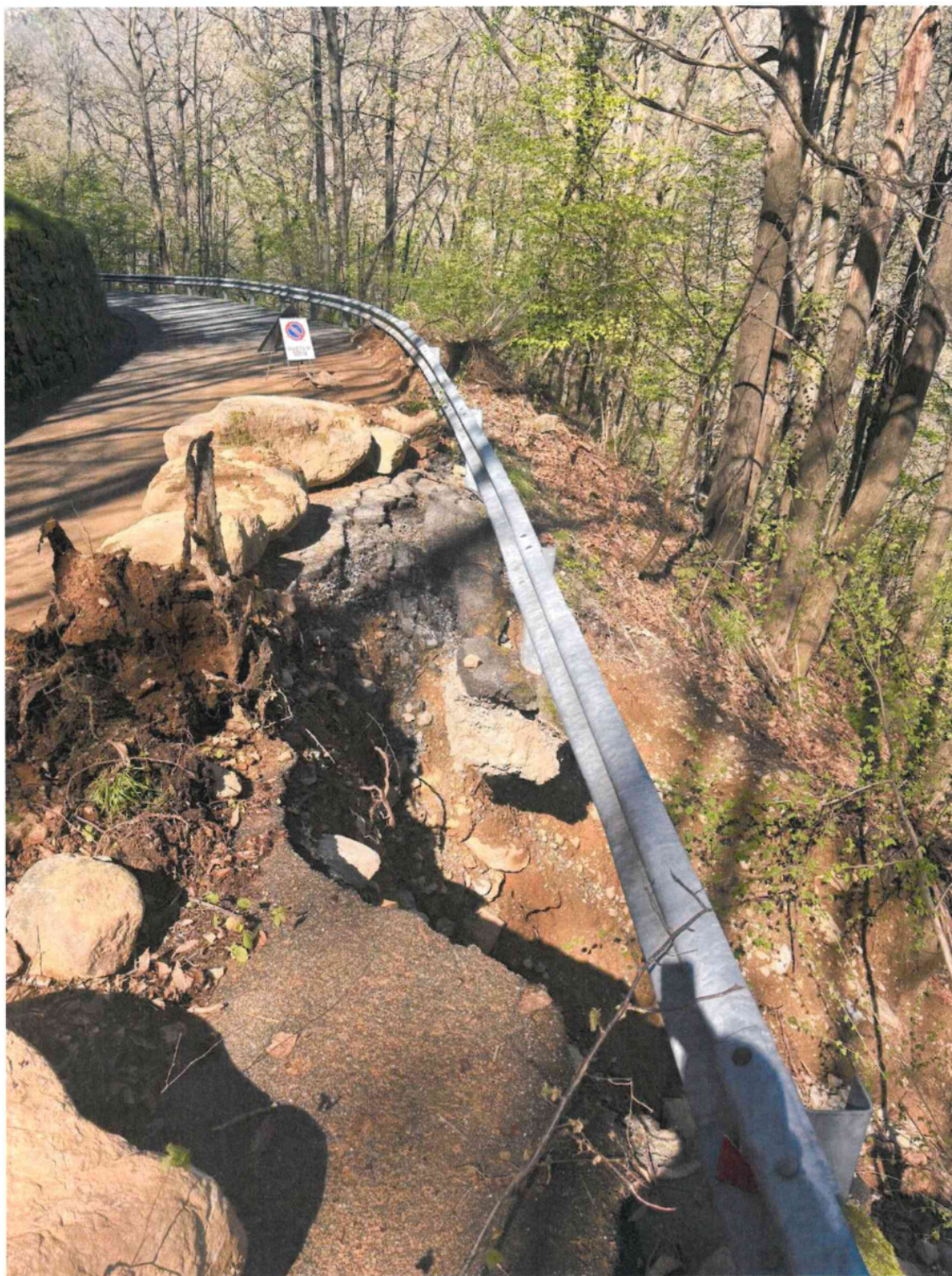
FOTO 2 : vista del secondo cedimento strutturale stradale nei pressi della Loc. Suc
