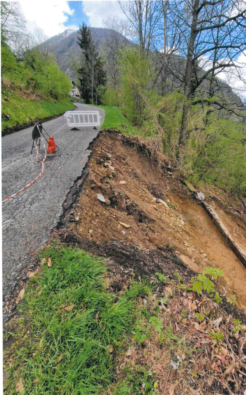
FOTO 2 : vista del cedimento strutturale stradale in loc. Mattet
