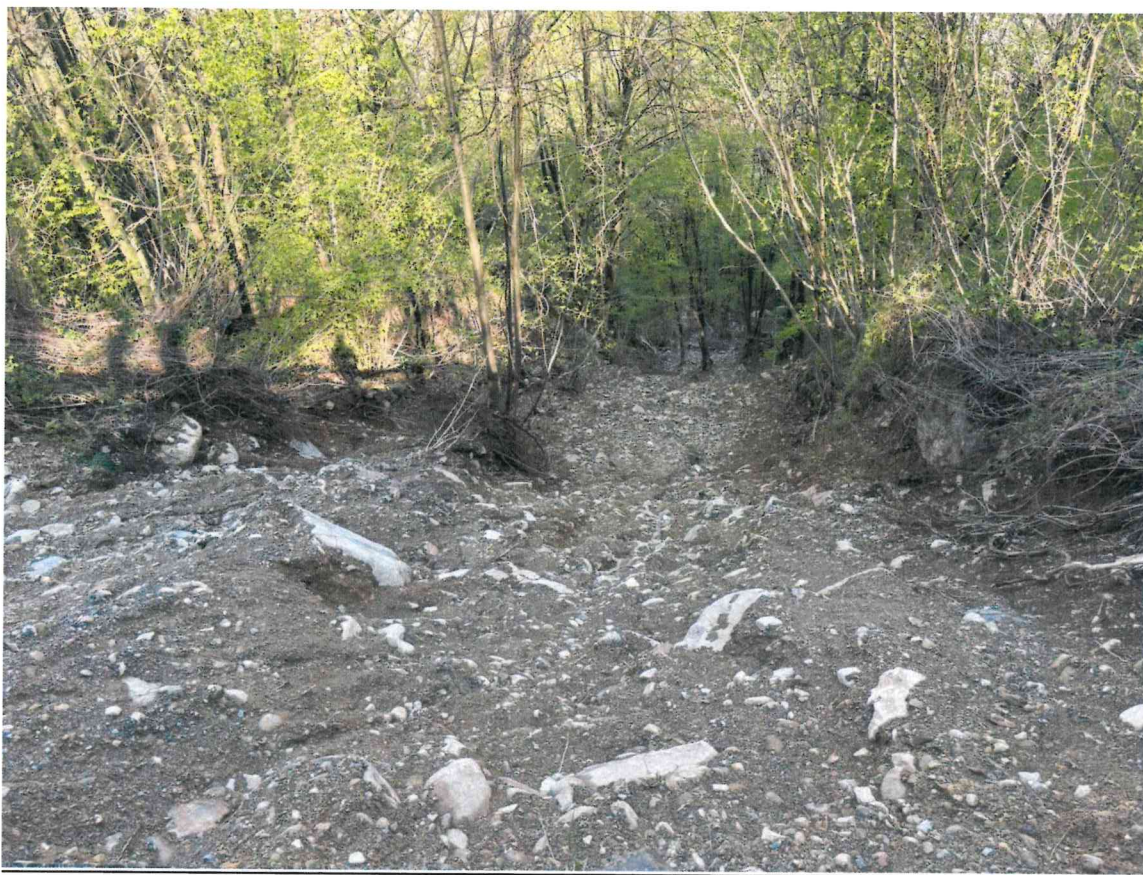
FOTO 1 : vista da monte del fenomeno franoso
