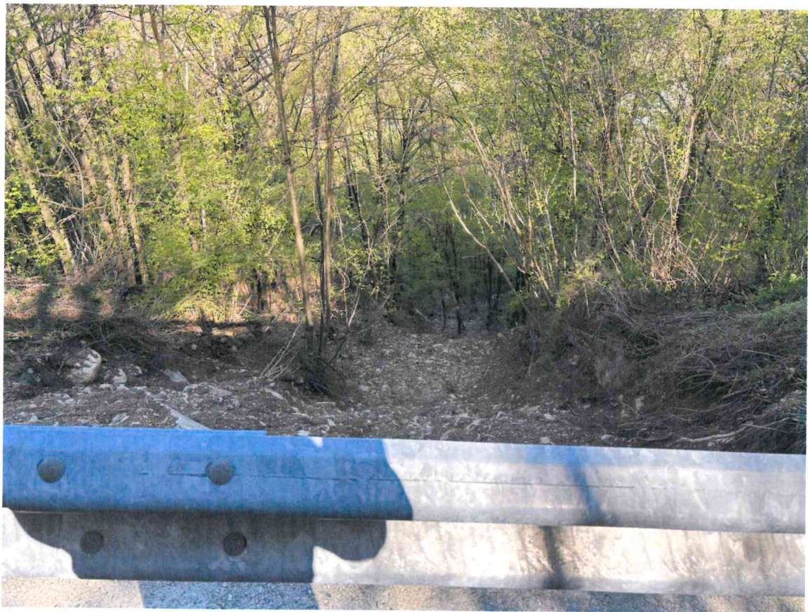
FOTO 4 : vista dalla strada del fenomeno franoso
