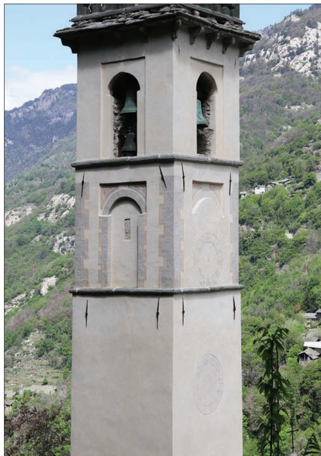
17. Particolare delle celle campanarie con le tracce dei due orologi. (D. Turcato)
