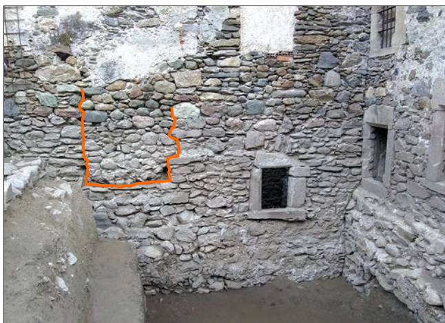
9. Saggio 3, vista del prospetto meridionale del corpo di fabbrica occidentale (USM 11); in arancione i limiti dell'apertura tamponata. (G. Sartorio)
