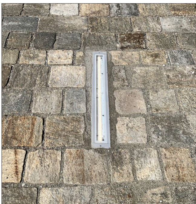
4-5. L'impianto di illuminazione durante e al termine dei lavori. (M. Pesciarelli)
