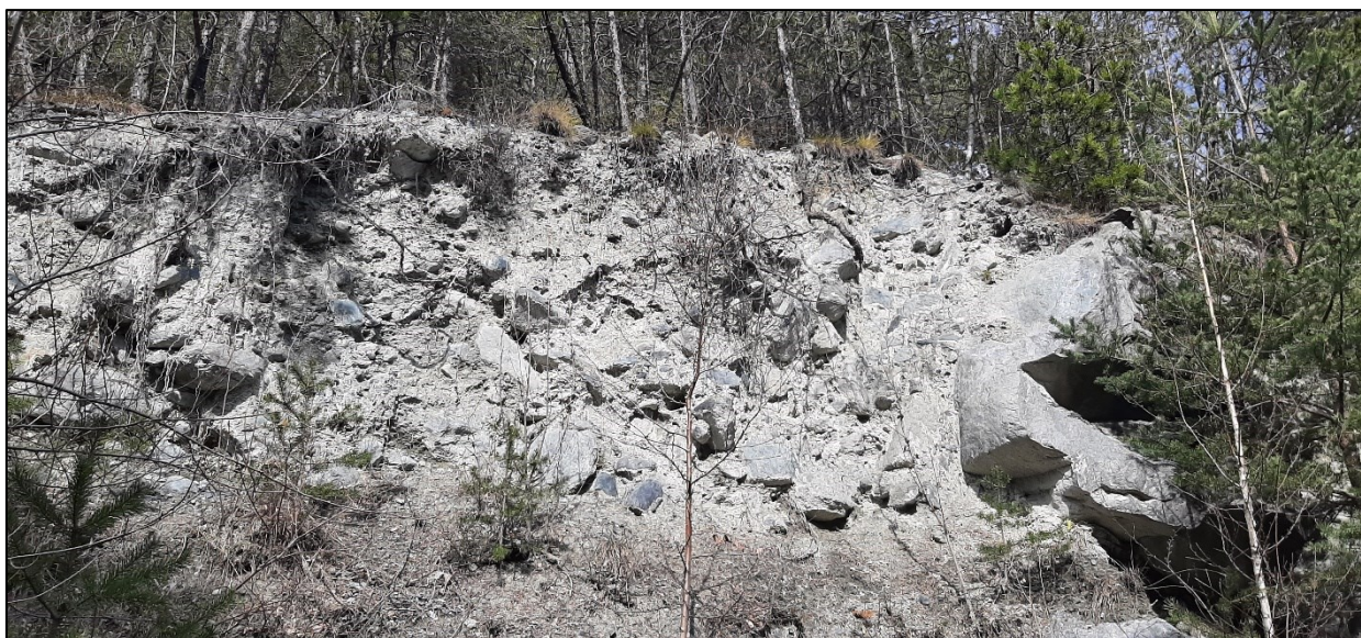
FIGURA 4-6 DEPOSITO DI ORIGINE GLACIALE SUL VERSANTE IN SINISTRA IDROGRAFICA DEL T. CHALAMY, AFFIORAMENTO PROSSIMO ALL'IMBOCCO DELLA GALLERIA / CABINA CALANCHI
