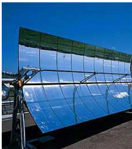
Impianto solare termodinamico a concentrazione
