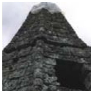
15. Particolare campanile prima del restauro. (N. Dufour)
