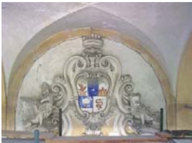
17. Fronte sud: decorazione a stucco sopraporta prima del restauro. (Zoppoli & Pulcher)
